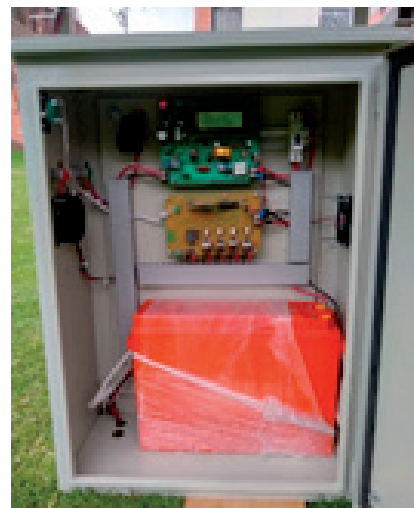
Figura 25. Vista Interior Ensamble
